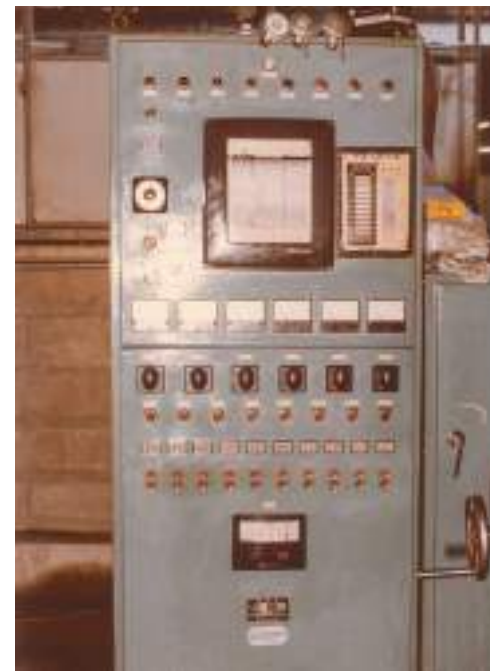
▲電気炉の操作盤
